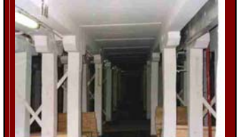
foto 12 - L'intervento in corso di ultimazione. Il tavolato superiore è stato completamente sostituito in uno alle botole
